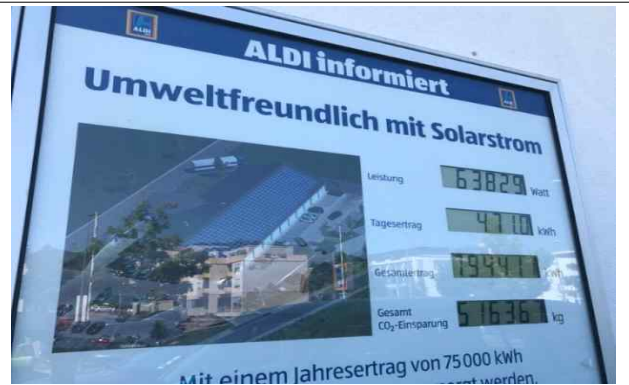
<태양광 주차장 계측 현황판>
