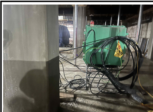
지하주차장 가설전기 안전관리 미흡
